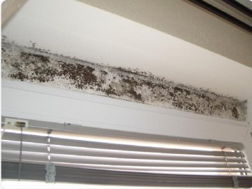
Plesen na konstrukcijskem toplotnem mostu - neizolirana preklada
